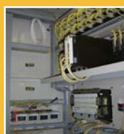
温泉施設制御盤 VCカプセル
